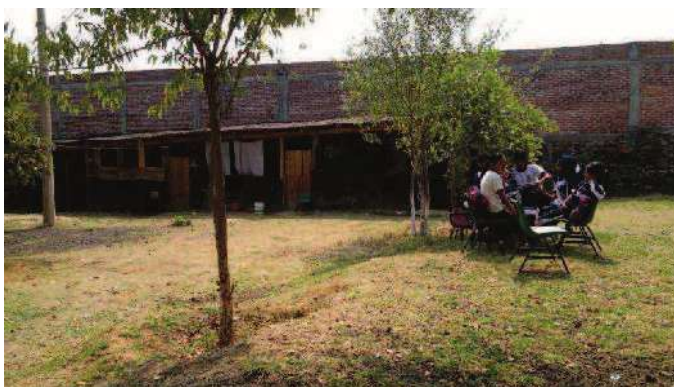
Imagen 16 : Vista al interior donde se aprecia que un edificio de aulas se encuentra apoyado sobre la barda de colindancia con el terreno vecino. Fotografías proporcionadas por el Instituto Nacional de Infraestructura Física y educativa. Captura realizada el 8 de septiembre de 2013
