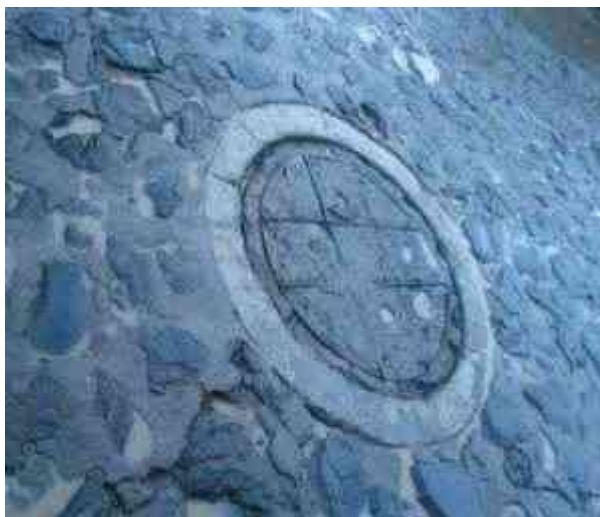
Fig. Drenaje y alcantarillado, fotografía tomada por María Fernanda León G.
