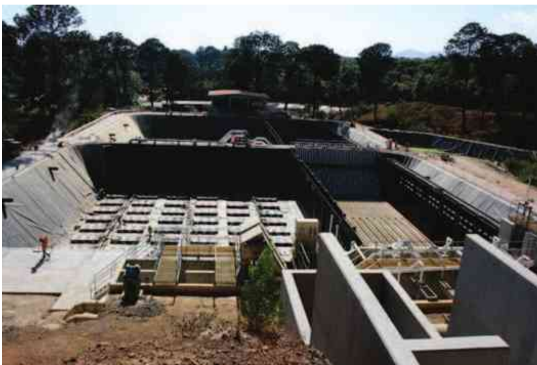
Fig. 23 La Planta de Tratamiento de Aguas Residuales San Antonio tendrá una capacidad de saneamiento de 300 litros por segundo, por lo que al entrar en operaciones se alcanzará una cobertura de saneamiento del 82 por ciento del total del agua residual. Revista infraestructura
