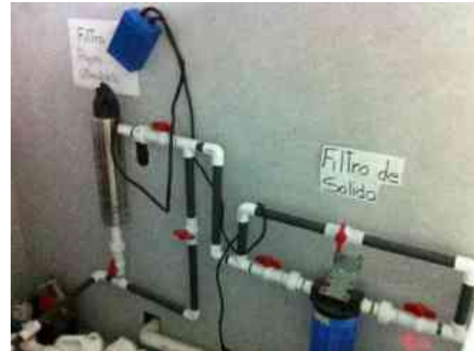
Ilustración 2 Cuarto de tratamiento de agua con osmosis inversa, área en la cual se hace el proceso de tratamiento del agua que va a servir para la hemodiálisis. Fuente: MSRR.
