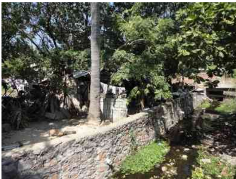
Foto 58 Invasión del cauce en toda la zona Federal del rio
