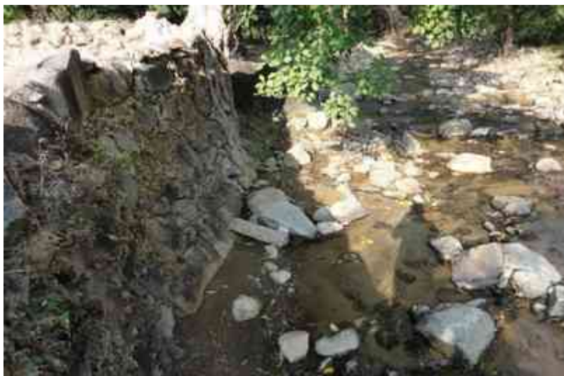
Foto 40 Colonias Morelos en riesgo de inundación debido a que cruza el rio Zapiro
