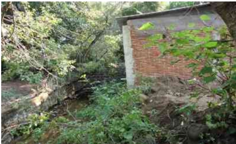
Foto 51 sitio en riesgo de inundación debido al arroyo que cruza
