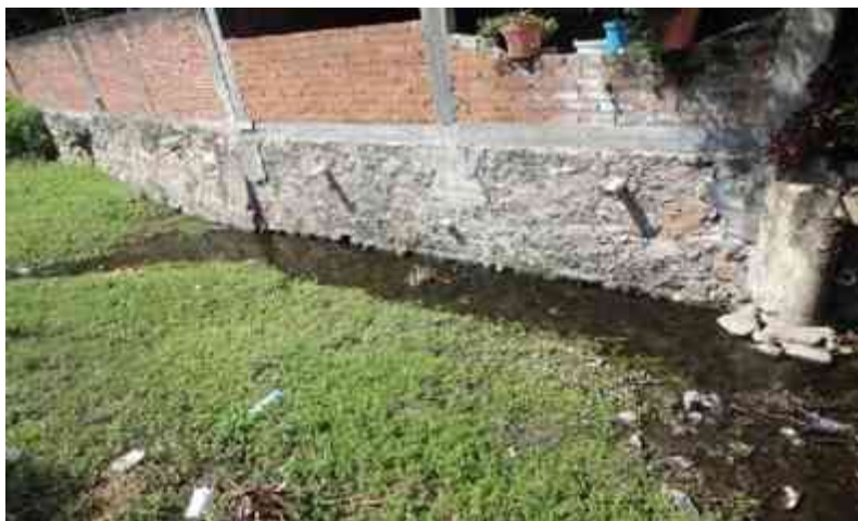
Foto 57 Riesgo de inundación a causa del rio verde.
