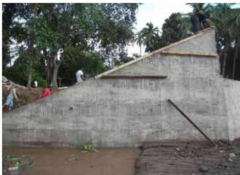
Foto 64 Afectación de puentes del rio Huamito
