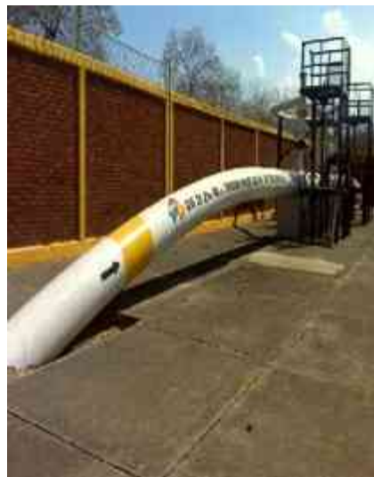
Foto 21, Válvula en las afueras de la localidad de Los Olivos.
