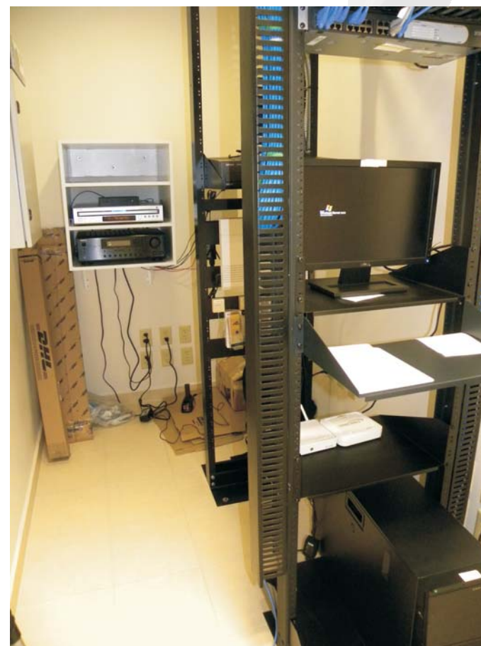
Cuarto de controles.
