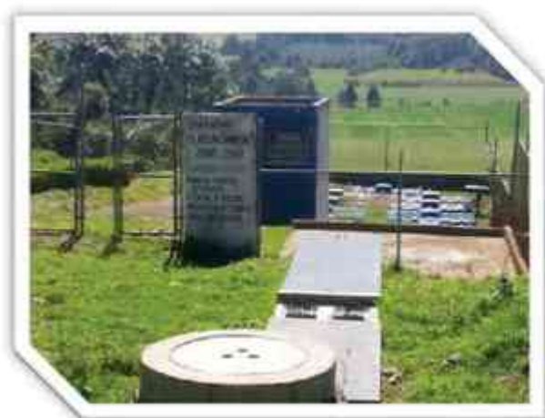
Imagen 36.- Planta de tratamiento de aguas servidas, ubicada al sur de la población de Charapan. Foto: Jesús Galván Sierra
