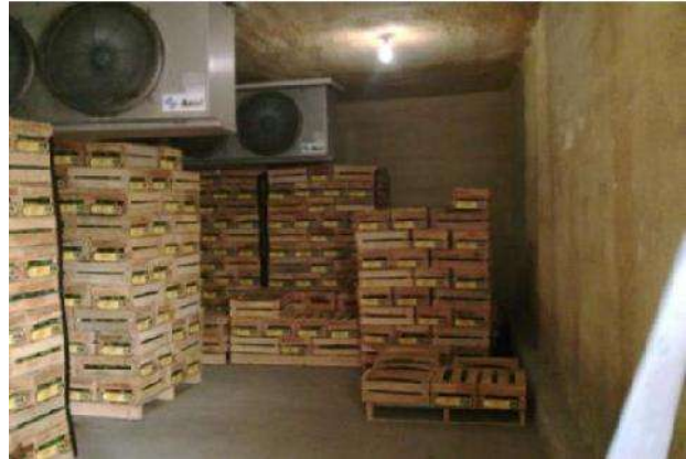
Imagen No. 62: Cámara de enfriamiento Fuente: https://www.google.com.mx/search?q=empacadora+de+aguacate+joselli&biw
