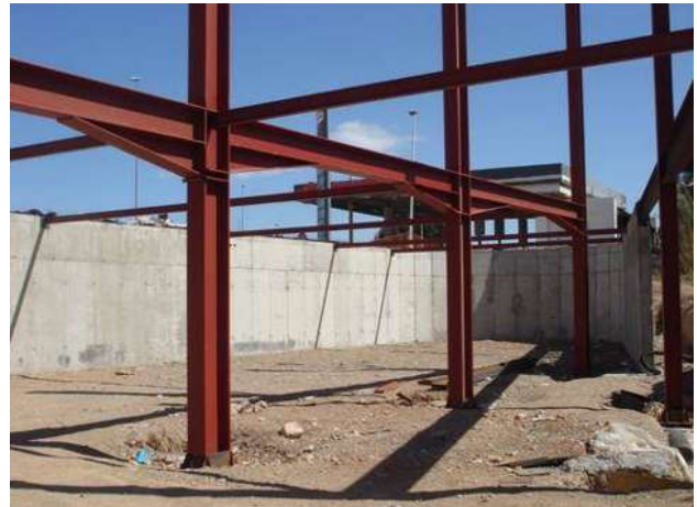
Imagen No.26: Columnas de acero Fuente: http://perfofijacionescxp.mex.tl/34902_Estructura-Metalica-.html
