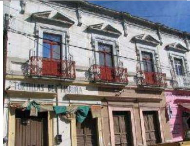
Fachadas con riesgos de colapso
