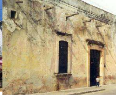
Fachadas con deterioro
