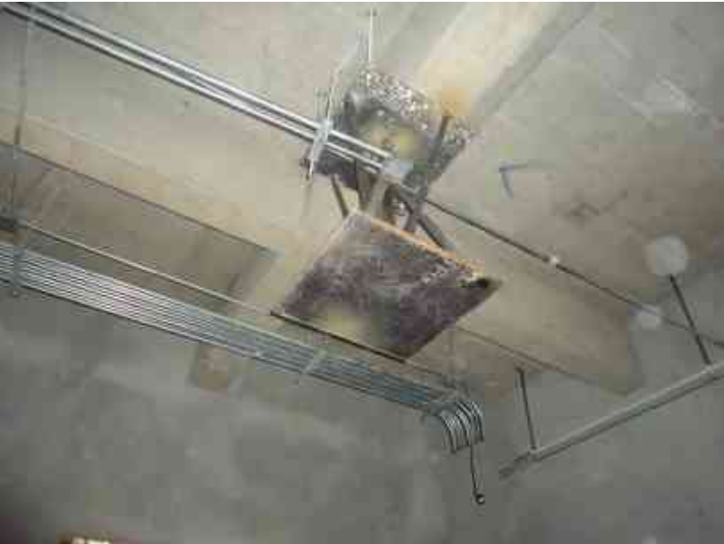
Imagen 30 Soporte Lámpara, Enrique Velázquez, autor, soporte en quirófano, se observa el reforzamiento para soportar el peso de la lámpara, 8 de Diciembre de 2014.
