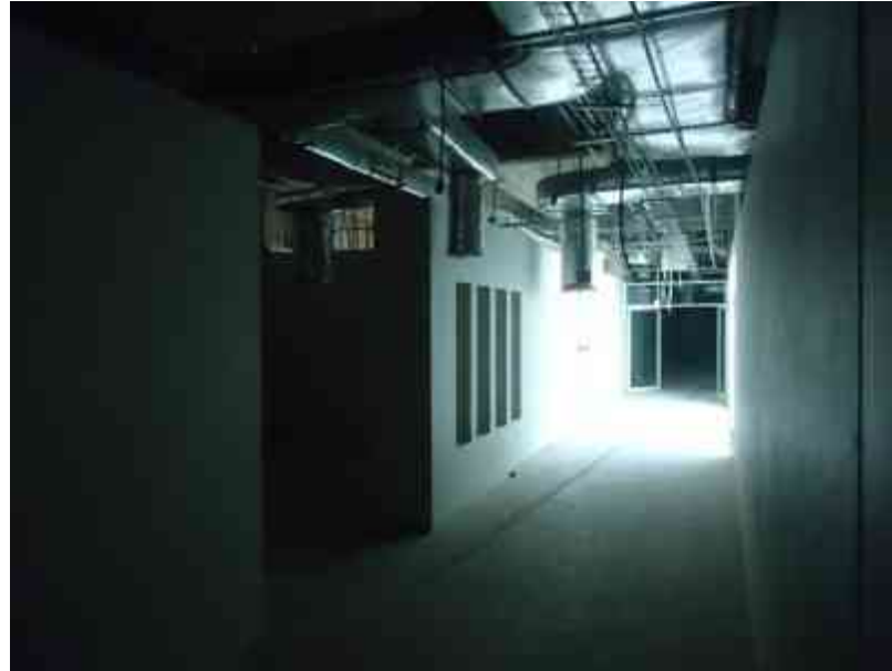
Imagen 31 Pasillo, Enrique Velázquez, autor, pasillo sin plafón donde se puede observar las instalaciones, 8 de Diciembre de 2014.
