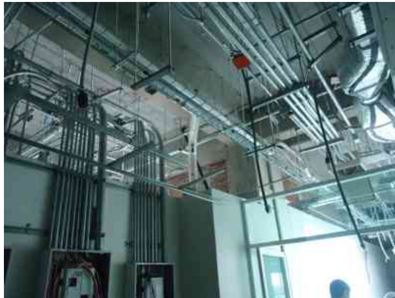
Imagen 32 Tableros Eléctricos, Enrique Velázquez, autor, distribución de cableado eléctrico hacia tableros, 8 de Diciembre de 2014.
