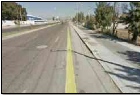
Foto 15 Tema: Coladera en Vía Principal
