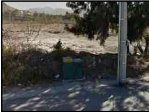
Foto 19 Transformador de Luz en Banqueta
