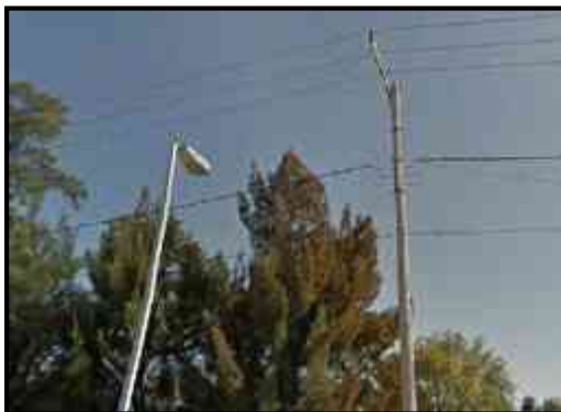
Foto 21 Tema: Poste de Electricidad
