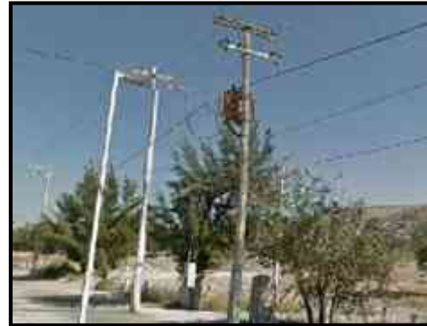
Foto 20 Tema: Transformador de Luz en Poste
