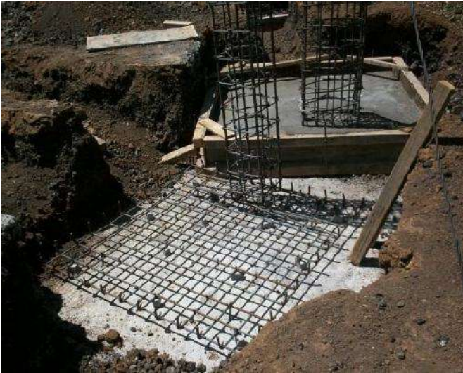
FOTO 12: COLOCACIÓN DE ARMADO DE PARRILLA Y DESPLANTE DE COLUMNA EN ZAPATAS DE CIMENTACIÓN FUENTE: LOGÍSTICA ARQUITECTÓNICA. FECHA: 31 DE MARZO DE 2012
