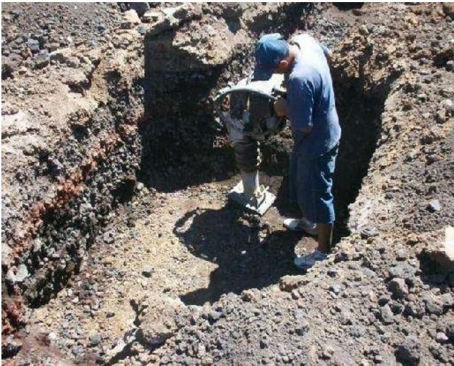
FOTO 10: COMPACTACIÓN DEL TERRENO CON EQUIPO MECANICO FUENTE: LOGÍSTICA ARQUITECTÓNICA. FECHA: 14 DE MARZO DE 2012
