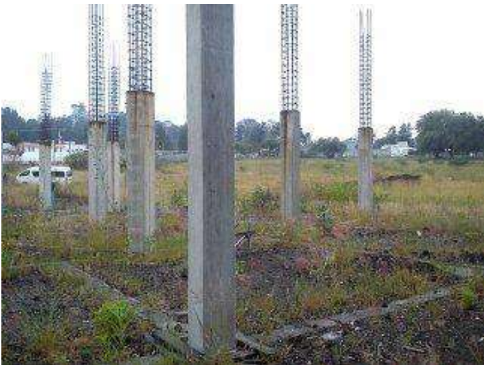
FOTO 17: ESTADO DE LA OBRA ANTES DE REAUNAR SU CONSTRUCCIÓN FUENTE: ITZEL RIVERA FECHA: 22 DE SEPTIEMBRE DE 2014
