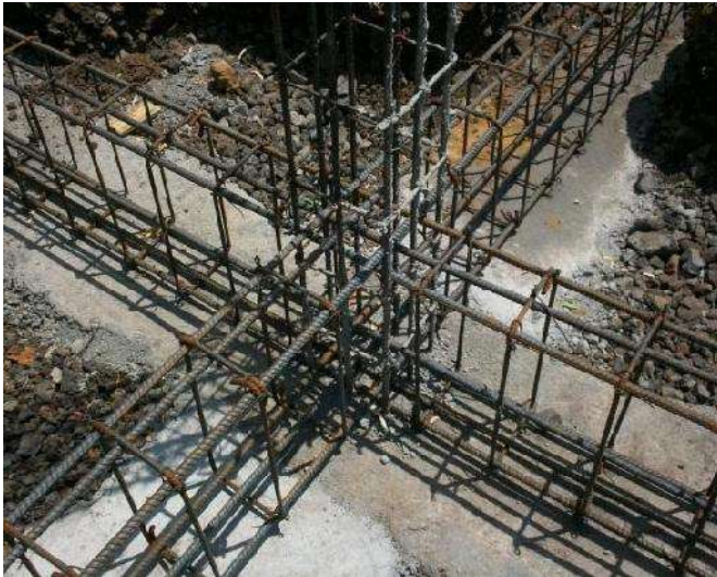
FOTO 14: HABILITADO Y ARMADO DE CONTRATRABE TIPO CT-3 ARMADO CON 6 VARILLAS #5 Y 2 VARILLAS #4, ESTRIBOS @20 CM.
