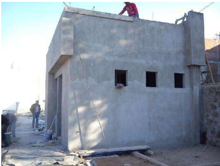
FOTO 58: APLANADO EN MUROS CON ACABADO FINO CON MEZCLA DE MORTERO-MARMOLINA 1:4 DE 0.5 CM DE ESPESOR. FUENTE: ITZEL RIVERA FECHA: 03 DE MARZO DE 2015.
