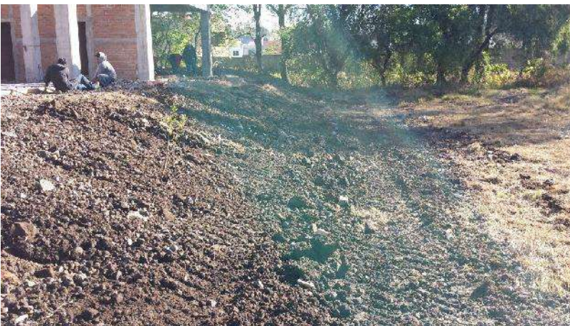
FOTO 32: CONSTRUCCION DE TALUD DE ARROPE A PLATAFORMA MEDIANTE LA COLOCACIÓN DE MATERIAL TIPO GREÑA FUENTE: ARQ. MARTIN CALDERON FECHA: 08 DE ENERO DE 2015
