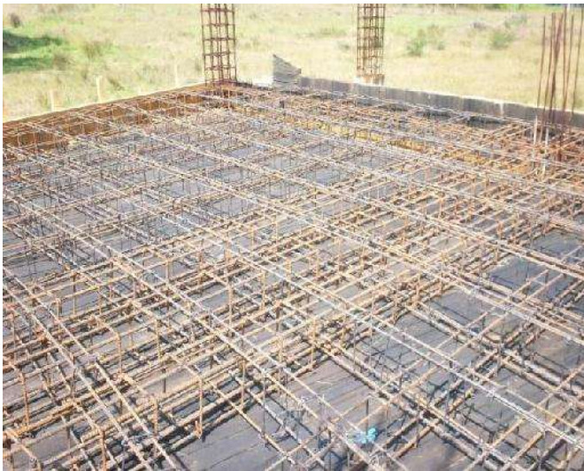
FOTO 21: HABILITADO Y ARMADO DE NERVADURAS EN LOSA RETICULAR. FUENTE: LOGISTICA ARQUITECTONICA FECHA: 20 DE OCTUBRE DE 2014
