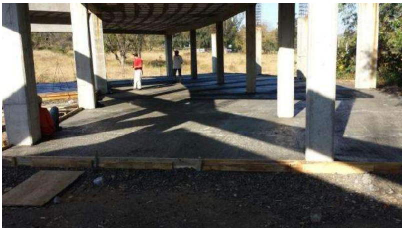
FOTO 27: LOSA DE CIMENTACIÓN TERMINADA. FUENTE: ARQ. MARTIN CALDERON FECHA: 01 DE DICIEMBRE DE 2014
