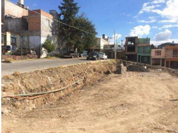
FOTO 36: NIVELACIÓN DEL TERRENO MEDIANTE LA CONSTRUCCION DE PLATAFORMA SUPERIOR. FUENTE: ARQ. MARTIN CALDERON FECHA: 08 DE DICIEMBRE DE 2014.
