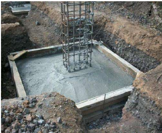
FOTO 13: COLADO DE DADO DE CONCRETO ARMADO DE 30X30 CM Y 40 CM DE ALTURA ARMADO CON 8 VARILLAS DEL #3 Y ESTRIBOS DEL #2 @ 20 CM. f'y=4200 \text{ kg/cm}^2 , CONCRETO PREMEZCLADO F'c 250 \text{ kg/cm}^2 Y CIMBRA COMUN. FUENTE: LOGÍSTICA ARQUITECTÓNICA. FECHA: 26 DE MARZO DE 2012
