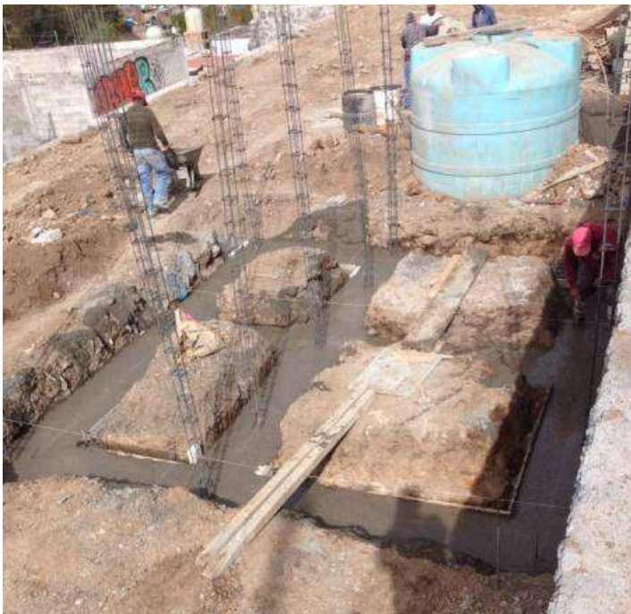
FOTO 54: CONSTRUCCIÓN DE ZAPATAS CORRIDAS DE CONCRETO ARMADO CON VARILLAS DEL #3 A CADA 20 CM EN AMBOS SENTIDOS Y ARMADO DE CASTILLOS.
