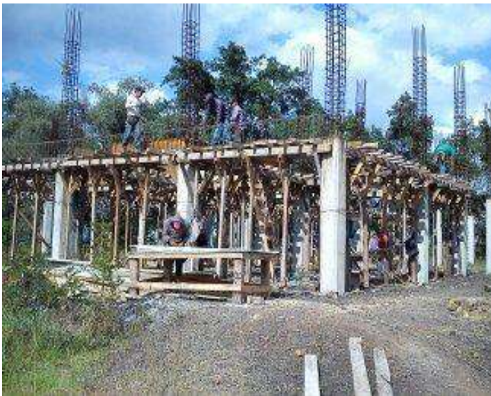
FOTO 18: HABILITADO, ARMADO Y CIMBRA APARENTE EN TRABES. FUENTE: ITZEL RIVERA FECHA: 30 DE SEPTIEMBRE DE 2014
