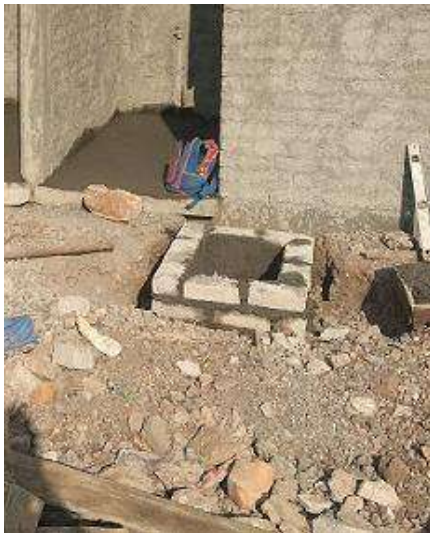
FOTO 61: REGISTRO SANITARIO DE 40X60X60 CM DE TABICON DE CONCRETO Y ACABADO PULIDO EN INTERIOR. FUENTE: ITZEL RIVERA FECHA: 22 DE ENERO DE 2015.
