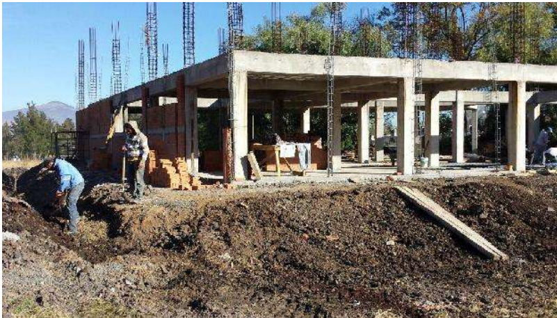
FOTO 31: CONSTRUCCION DE TALUD DE ARROPE A PLATAFORMA MEDIANTE LA COLOCACIÓN DE MATERIAL TIPO GREÑA FUENTE: ARQ. MARTIN CALDERON FECHA: 05 DE ENERO DE 2015
