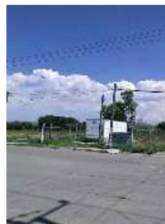
Imagen No. 35. Postes de línea telefónica. Fuente: Foto tomada por autor
