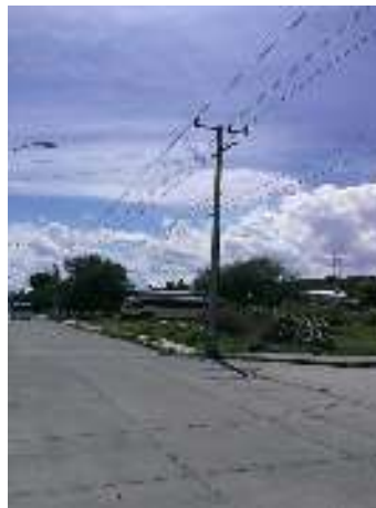
Imagen No. 34. Poste de CFE ubicado en la esquina de las calles Javier Mina y Barranquilla. Fuente: foto tomada por Juan Martínez
