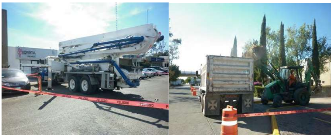
Fig. 6 y 7. Delimitación de la maquinaria 26
