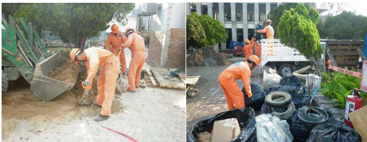
Fig. 2 y 3 limpieza y orden en las áreas de trabajo. 22
