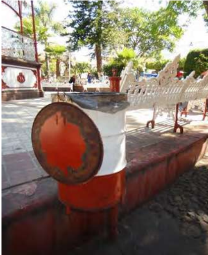
Ilustración 67. Basurero presenta deterioro en algunos elementos en la plaza
