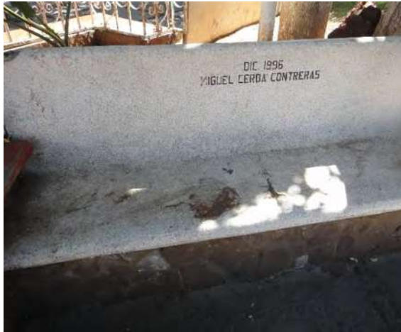
Ilustración 70. El vandalismo y falta de mantenimiento en el mobiliario urbano
