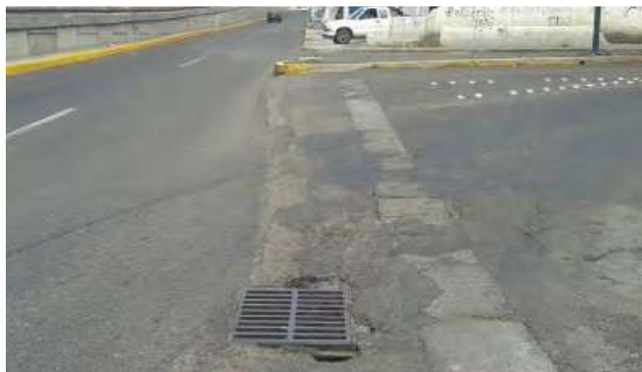
Imagen 50. Reja de la red general de alcantarillado sobre el circuito periférico.
