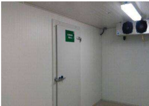
CAMARAS FRIAS: Vista del interior, con los equipos ya instalados y aptos para funcionar.
