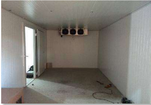
CAMARAS FRIAS: Interior de las cámaras frías, donde se consideraron instalaciones particulares para mantener a cierta temperatura los medicamentos allí guardados.
