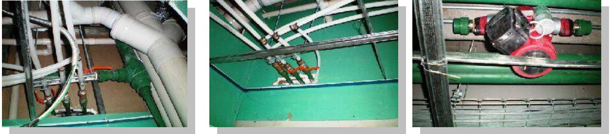
Instalación Hidráulica "Tubo plus mixto" (Cámara José Antonio Moreno G.)
