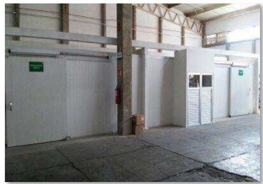
CAMARAS FRIAS: Terminación de esta partida, considerando un tablero de control que permite monitorear la temperatura de los ventiladores, todo calculado según las normatividades solicitadas por el departamento de construcción del IMSS.
