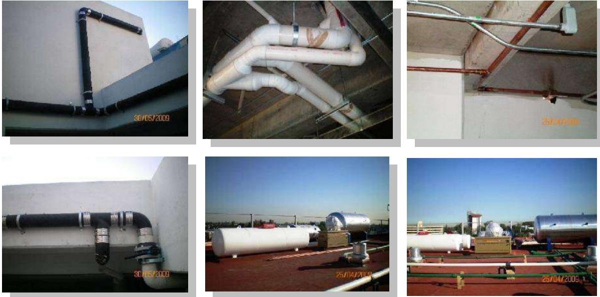
Instalación sanitaria, "PVC Sanitario y Fo. Fo." (Cámara José Antonio Moreno G.)
