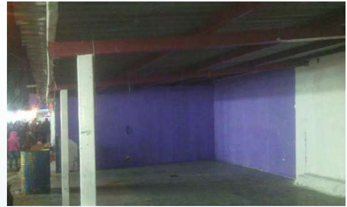
Foto 8 Local comercial vacío 1 tomada por autores
