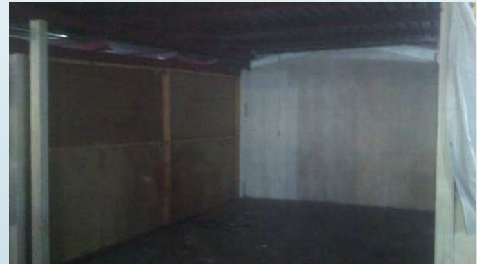
Foto 9 Local comercial vacío 2 tomada por autores
