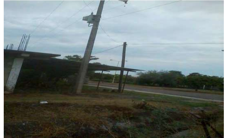
Poste con transformador calle Gral. Custodio Martínez: Fuente: fotografía Propia.
