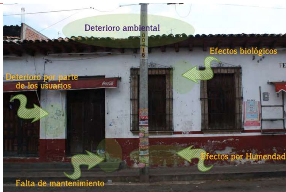
Imagen 057.- Deterioros ambientales, biológicos y sociales en fachadas del poblado.
