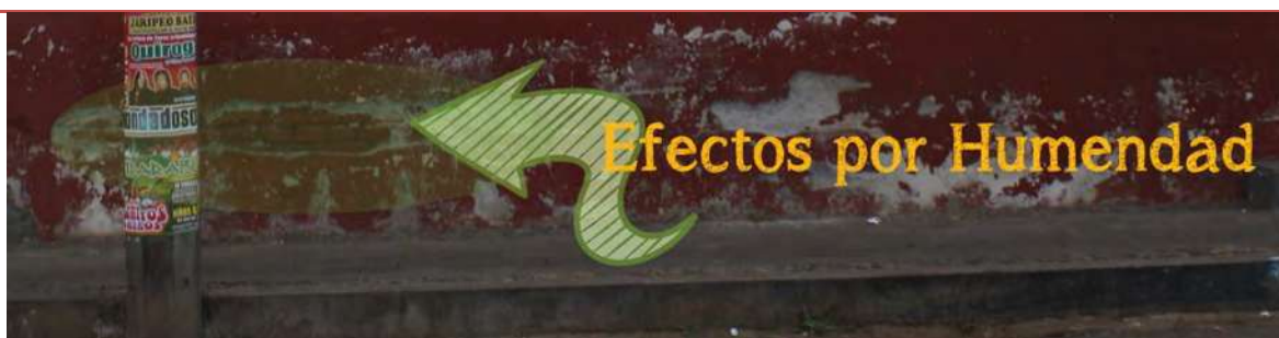
Imagen 058.- Efectos por humedad
