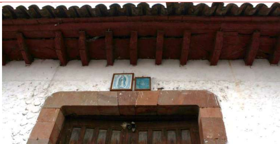
Imagen 060.- Presencia de telarañas
