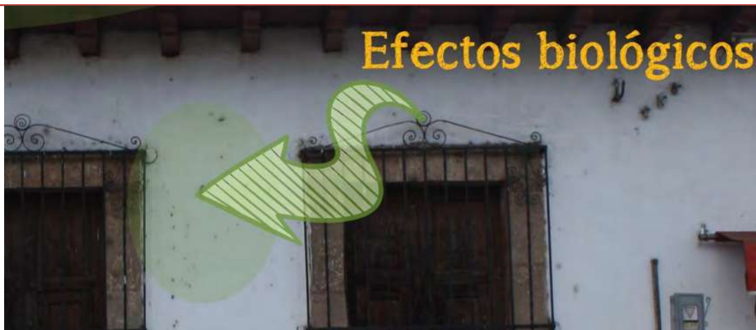
Imagen 059.- Presencia de telarañas
