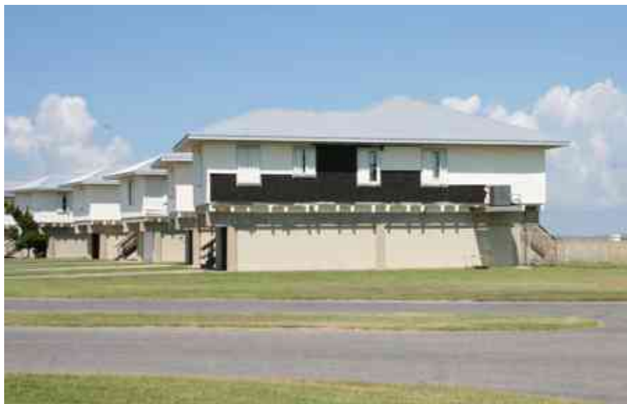
Fig.56. Vinil faltante en fachadas. Autor: JAPG.
