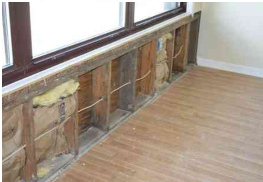
Fig. 60. Tablaroca faltante por daños causados por humedad. Autor: JAPG.
