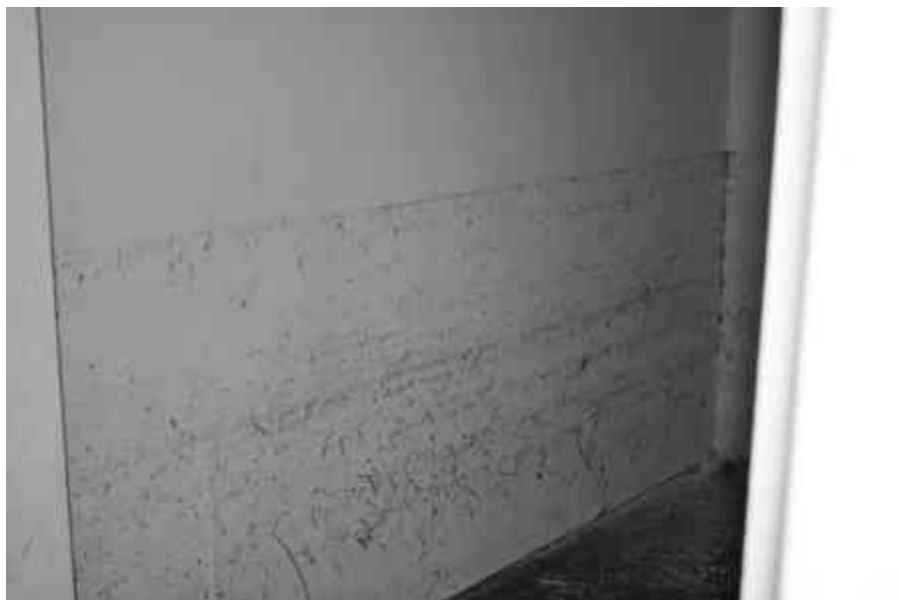
Fig. 62. Evidencia del nivel alcanzado por el agua en muros bajos. Autor: JAPG.
