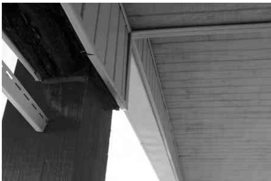
Fig. 65. Deterioro de viga por humedad. Autor: JAPG.
