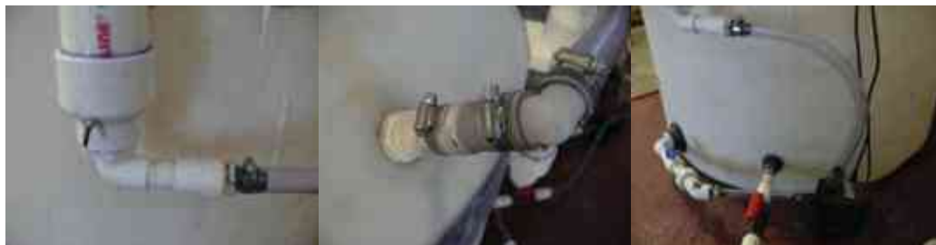
Fig. 23-25. Cuarto de máquinas: bomba para el llenado de tinas con interruptores en cada unidad individual y válvulas eléctricas. Autor: JAPG.
