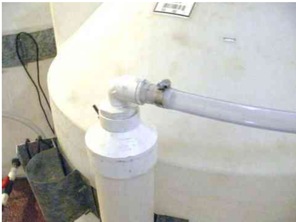
Fig. 22. Cuarto de máquinas: tanques de polietileno de 6,000 litros aproximadamente. Autor: JAPG.
