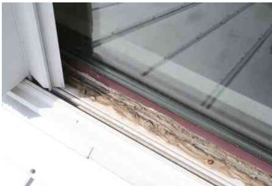
Fig. 59. Sello deteriorado alrededor de ventanas. Autor: JAPG.
