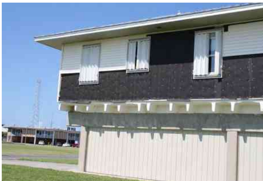
Fig. 57. Vinil faltante en fachadas (acercamiento). Autor: JAPG.
