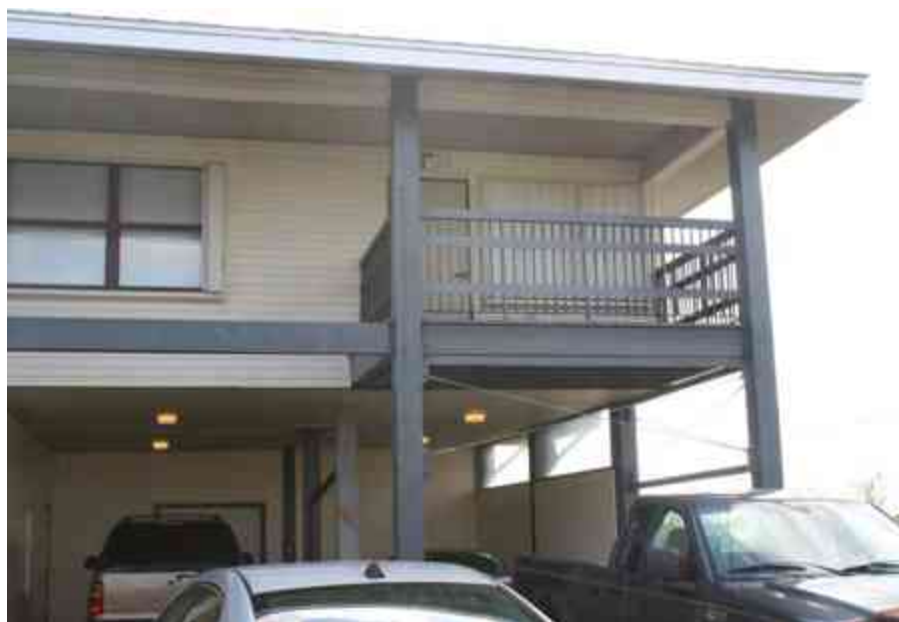
Fig. 63. Pilares de madera a remplazar. Autor: JAPG.
