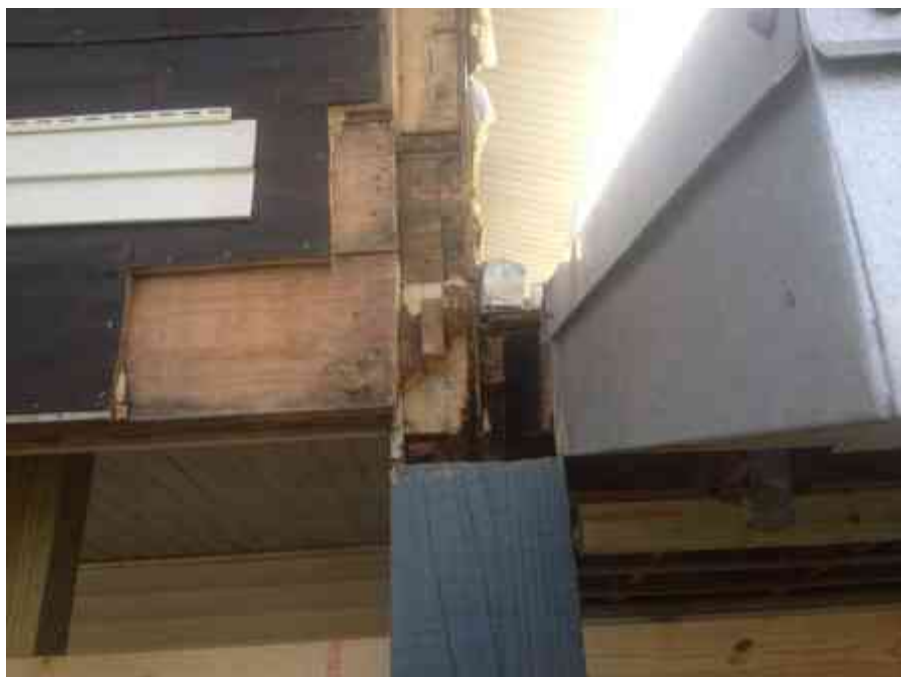
Fig. 69. Daños por humedades. Autor: JAPG.
