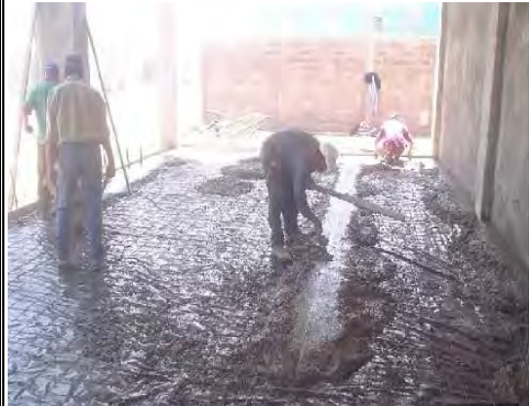
Imagen No. 57 Nombre: Imagen donde se aprecia cómo se realiza un firme, está la tierra apisonada y después la malla electro soldada y al final viene el concreto. Fuente: http://www.aguascalientes.gob.mx/transparencia/calidad/sop/obras/ReportesVarios/fotostransp.asp?StrIdContrato=4624
