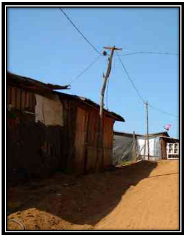
Figura 26. Postes de luz y cableado aéreo.
