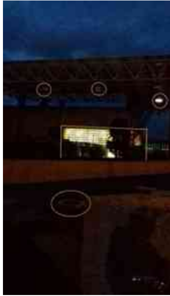
Fig. 60. Unas cuantas luminarias funcionando en la explanada de la UMF. Poca visibilidad para los usuarios. Fuente: MISV Fecha: enero 2017.
