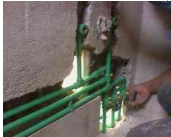
Ilustración 56 Instalación hidráulica con tuboplus. Imagen: [ http://guiamexico.com.mx/empresas/fontanero-xalapa-1.html , FECHA DE CONSULTA ENERO/2017]
