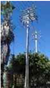
Ilustración 95. Poste de energía eléctrica en la esquina del terreno. Autor: RMA
