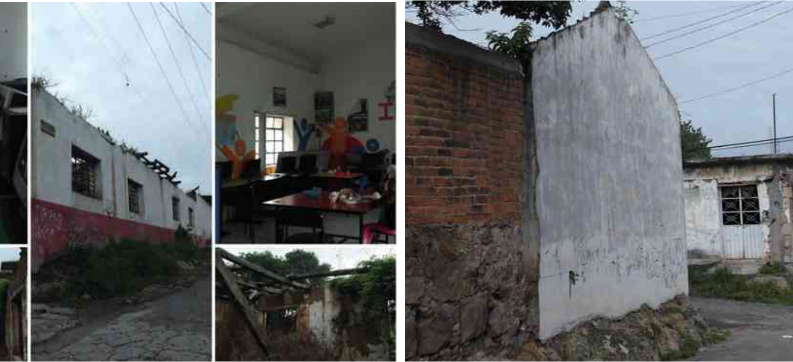
Fig. 05 Condiciones actuales exterior e interior de Centro de Desarrollo Comunitario, Es Evidente el deterioro de las instalaciones. Tenencia de Santiago Undameo, Morelia, Moreno, A. 02/09/2016.
