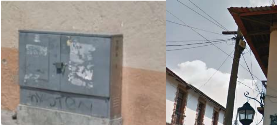
Foto 31: Cableado telefonico y cajas de control
