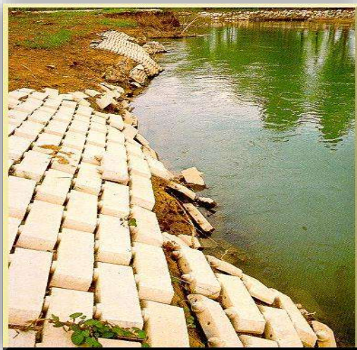
Fig. 37. Falla en un proyecto que contempló bloques de concreto, que se debió a la falta de flexibilidad por parte de los mismos. Víctor M. Ponce.
