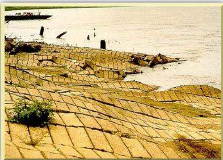
Fig. 38. El material empleado en este caso ha fallado también debido a la misma falta de flexibilidad por parte de los bloques. Víctor M. Ponce.
