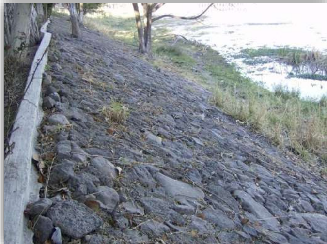
Fig. 135. Los taludes presentan un evidente deterioro debido a la macroflora. Juan Alberto Alduenda Sánchez.
