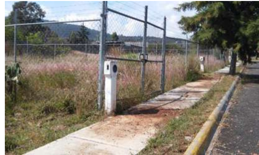
Fig. 4.15 Toma de energía eléctrica Foto: L.L.M [08/11/16]
