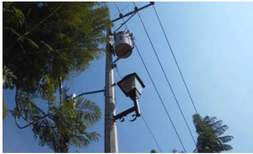
Fig. 4.14 Poste de luz Foto: L.L.M. [08/11/16]
