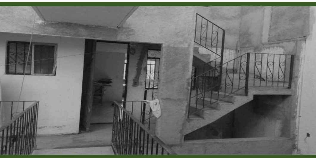
Img.04 Fotografías tomadas a edificio habitacional para estudiantes, Valle Quieto, Morelia Michoacán, Dueño: Ing. Ernesto Verduzco Sánchez, construido: 2007, previas remodelaciones 2016.
