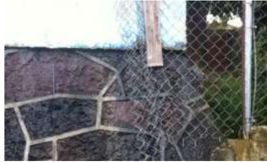
Foto. XXV. cimentación actual (filtración de agua), elaboración propia
