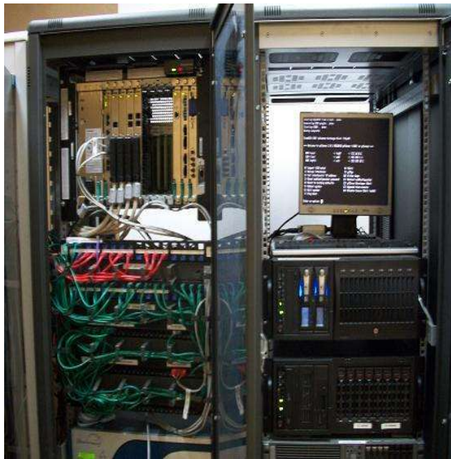
Rack de servidores.
