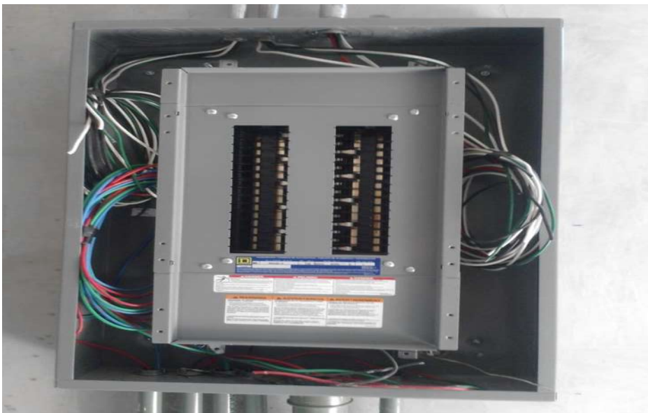
Instalación eléctrica en planta alta, cubículo de oficinas, obra CIDAM Morelia.
