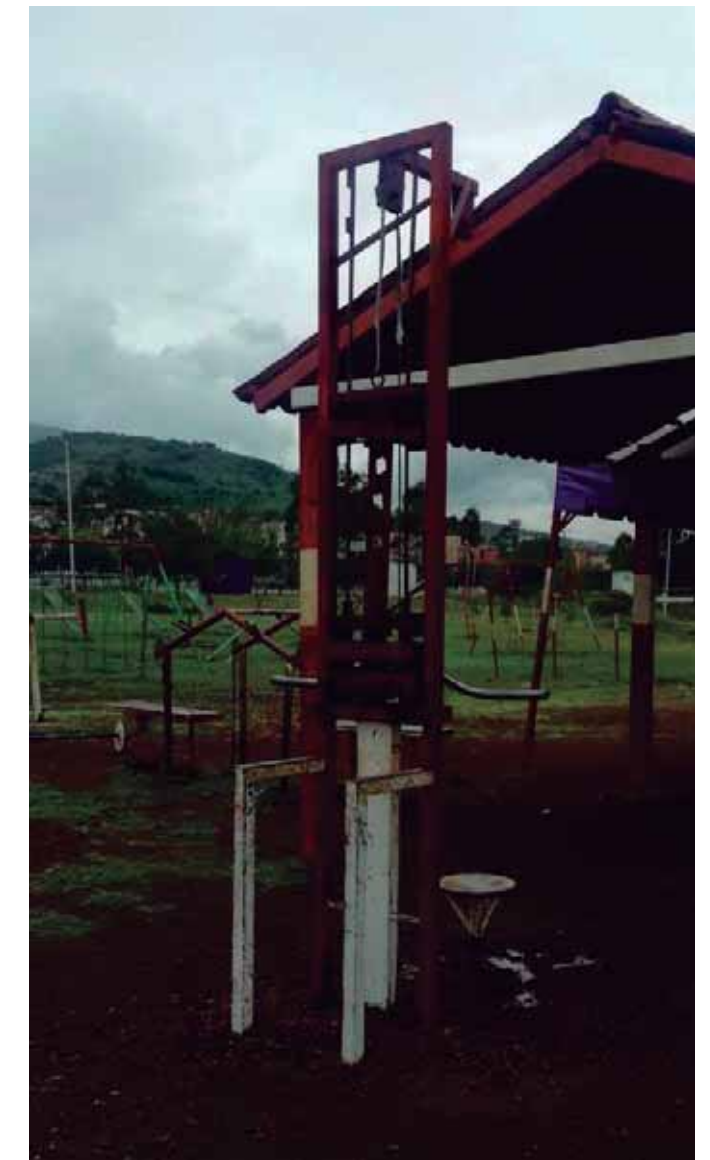
Ilustración 18. Estado actual de la Unidad Deportiva "MIGUEL HIDALGO". Fuente: quadratin.com.mx
