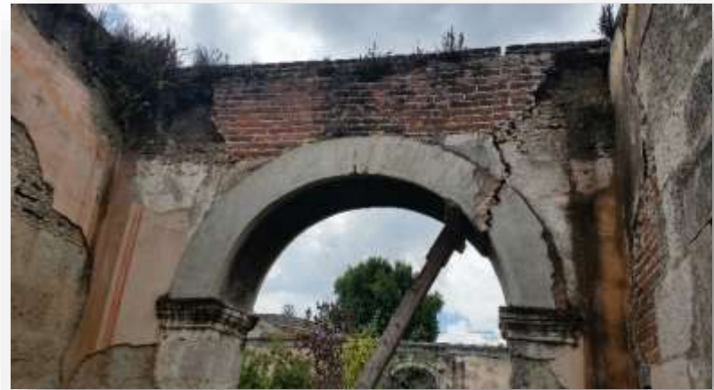
Imagen 12: Vista de un arco de la estructura modificado y en ruinas. Foto por autor.
