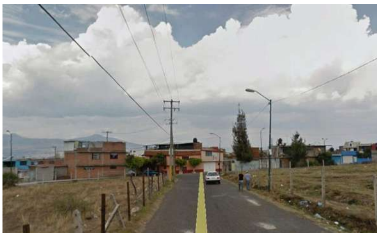
Imagen 41. Línea de electrificación y alumbrado público. Crédito: Jonathan Josué Vallines Contreras
