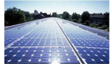
Fig. N° 123 Paneles Fotovoltaicos Fuente: http://www.esco-tel.com/Planta_solar_para_generacion_de_energia_electrica4.jpg
