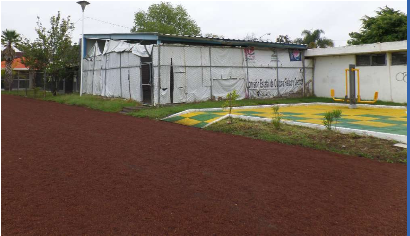
Imagen 65 Condiciones Antigua Instalación , Autoría propia, Juan Carlos Lazcano Martínez
