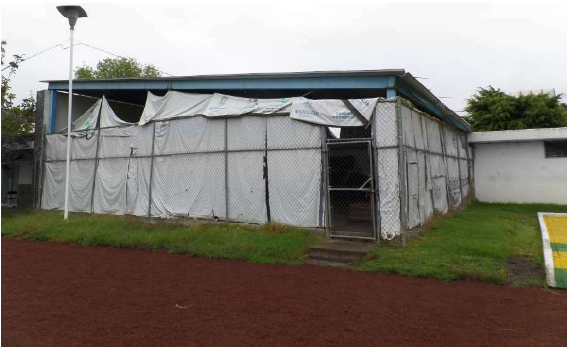
Imagen 66 Condiciones Antigua Instalación , Autoría propia, Juan Carlos Lazcano Martínez
