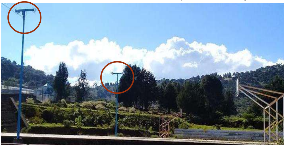
Ilustración 28: Reflectores cancha de básquetbol fuente: RAV [06/11/18]
