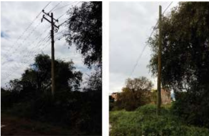
Imagen 26 Servicio de energía eléctrica y telefonía ubicados a un costado del predio, Fotografía tomada por FJLG (octubre 2018)
