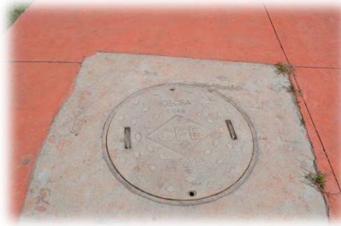
Figura 42. Infraestructura, electricidad. Fuente. Generada por la autora
