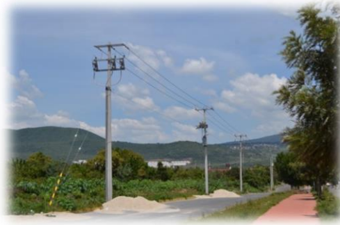
Figura 43. Infraestructura, electricidad. Fuente. Generada por la autora
