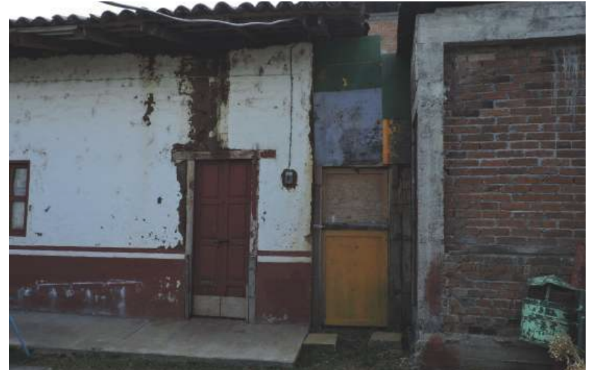
Figura 37. Mal estado de conservación
