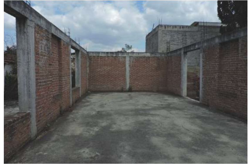
Figura 36. Edificación sin losa (salón de usos múltiples)
