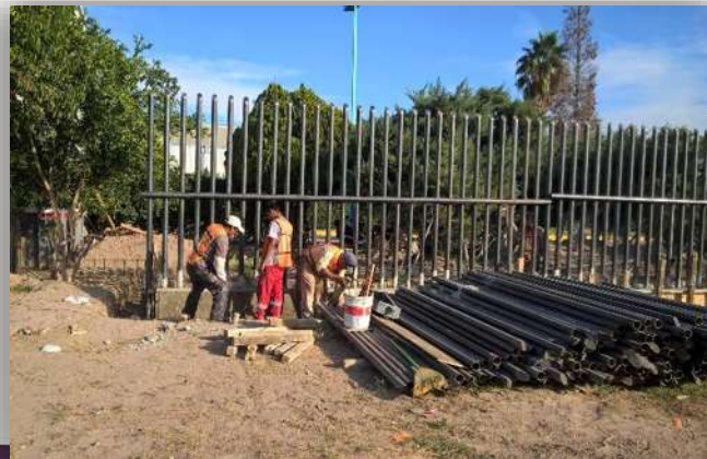
Imagen 68. Ejecución de valla perimetral en arco de acceso fuente.: Angel Domínguez. Consulta: 02/2016.
