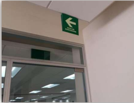
Imagen 106. Señalización de ruta de evacuación diferentes áreas. fuentes: Angel Domínguez. Consulta: 10 /2016.
