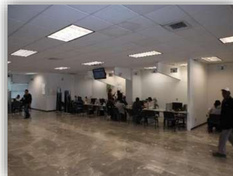
Imagen 25. Estado físico de la obra área contribuyentes. fuelle: visita de obra sat Torreón.Consulta11/2014.
