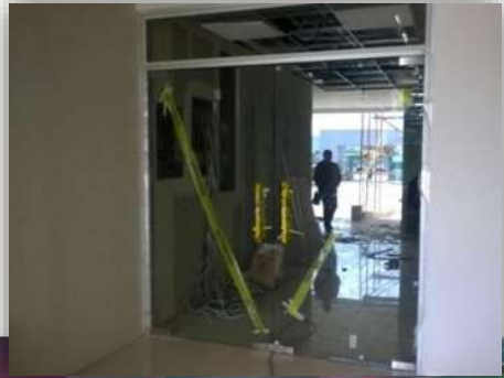
Imagen 83 habilitado de puertas de cristal templado en pasillo de edificio A. Fuente: Angel Domínguez. Consulta 01/2016.
