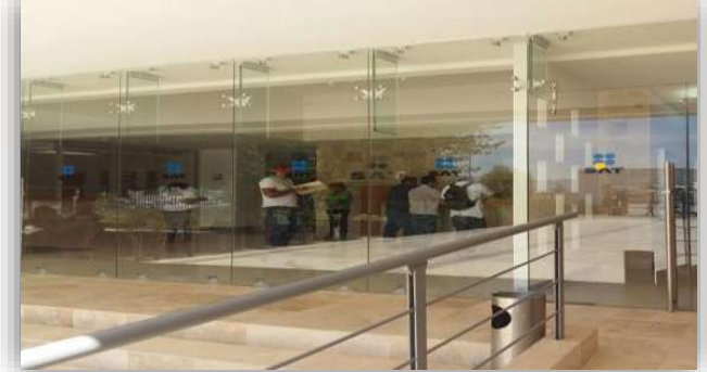
Imagen 81. Montaje de muro de cristal templado en acceso principal edificio A. fuente: Angel Domínguez. Consulta: 03/2016
