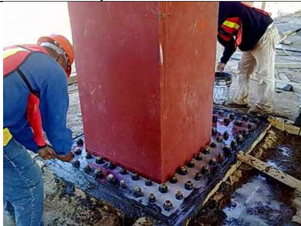
Imagen no. 68.- Colado de grout entre placa base y dado de cimentación.
