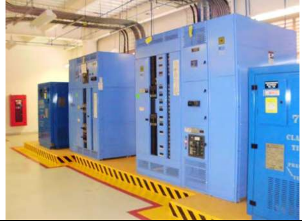
Imagen no. 101.- Subestación eléctrica.
