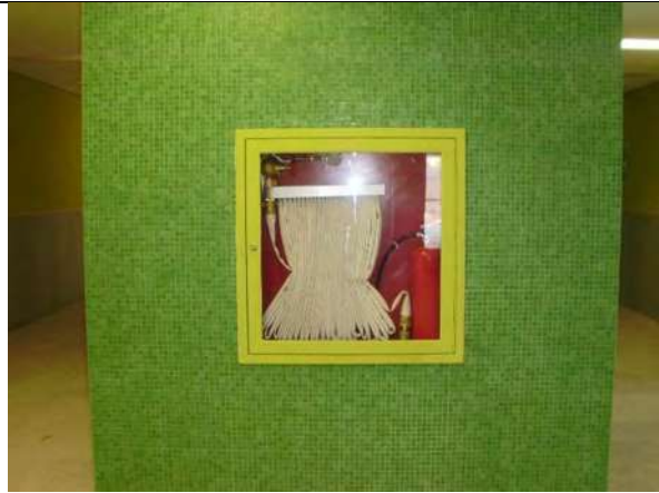
Imagen no. 92.- Gabinete de protección contra incendio.
