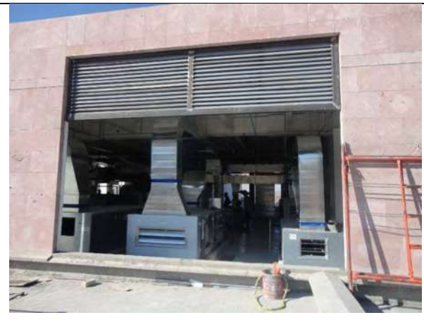
Imagen no. 95.- Casa de máquinas de aire acondicionado.
