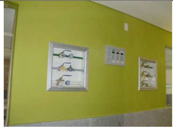
Imagen no. 93.- Cuadros de válvulas de gases medicinales.
