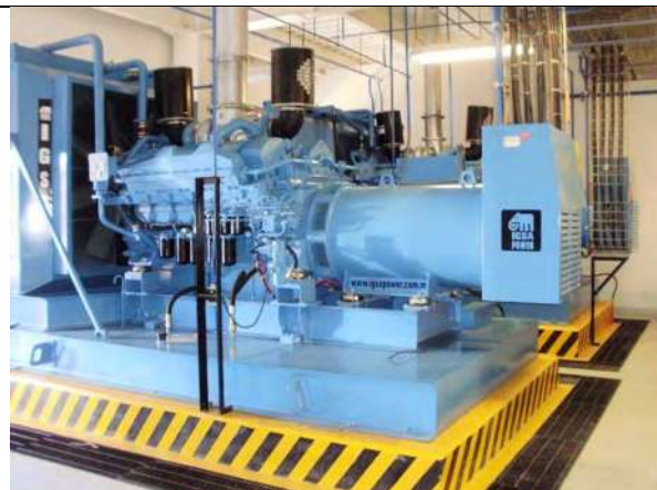
Imagen no. 102.- Casa de máquinas eléctrica.
