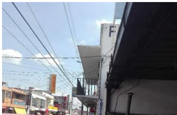
Ilustración 3 "cableado" la imagen nos muestra el cableado aéreo en la AV. Morelos, foto por. EAB
