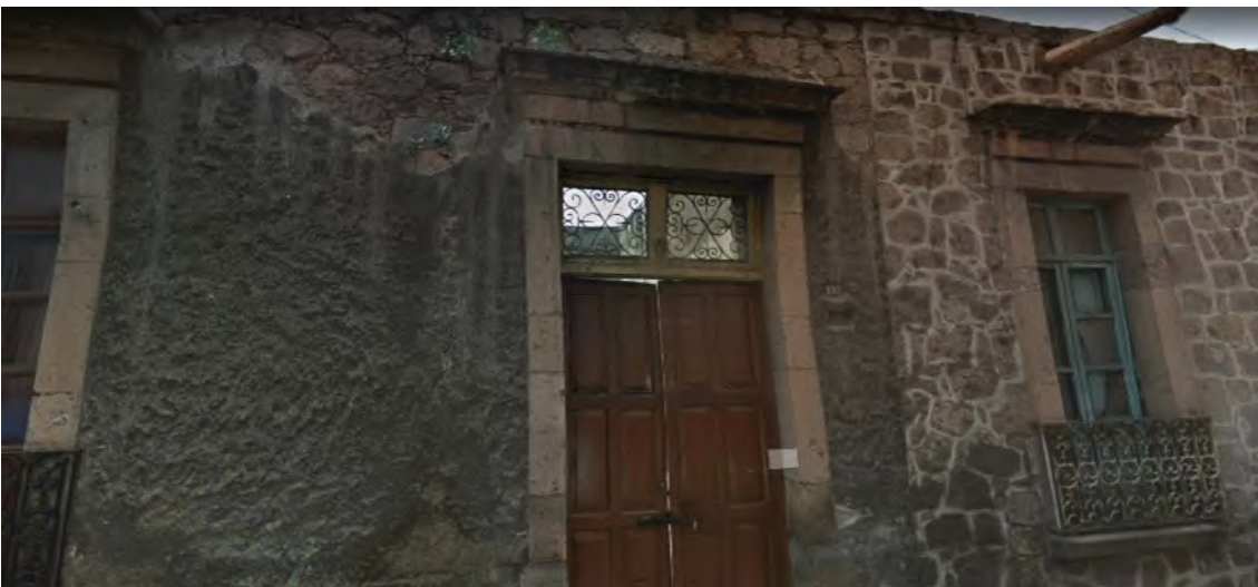
Ilustración 32. Inmueble ubicado en calle Plan de Ayala #107 (Fotografía). Tomada por autor.
