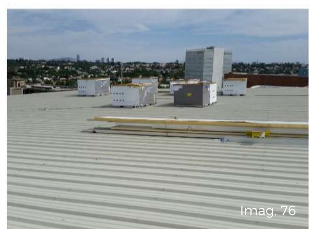
Imag. 71-74. Estructura de Cubierta en Ampliación Imag. 75-76. Equipos de Aire Acondicionado.
