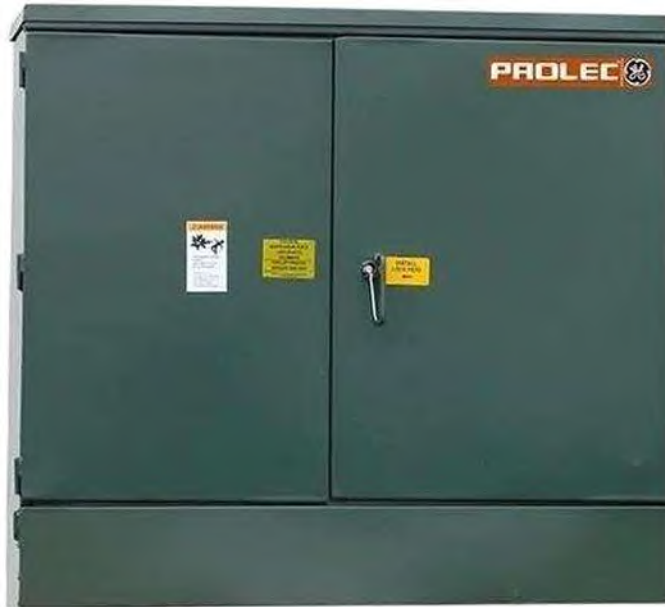
Imagen 129. Transformador. Recuperado de: https://articulo.mercadolibre.com.mx/MLM-569637464-transformador-45kva-pedestal-trifasico-13200-220-enviogratis-JM . [consultado: 11 de junio 2020].
