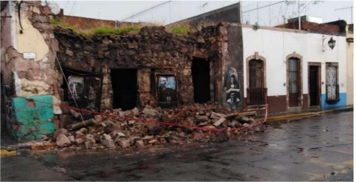
Imagen 6. Casa derrumbada por lluvia en el centro. Rescatado de: https://www.atiempo.mx/destacadas/por-intensa-lluvia-se-derrumba-ca-sa-en-centro-historico-de-morelia/ el 09/04/2020
